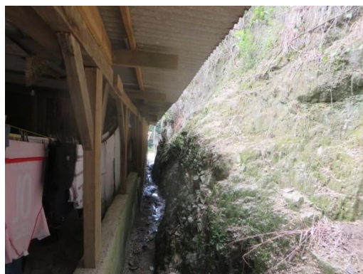
Figura 8. Residência muito próxima a corte no terreno, com surgência de água na base do corte. Setor SC_MASSARA_SR_1_CPRM.
