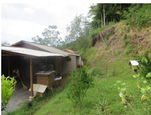
Figura 11. Residência mista em madeira e alvenaria muito próxima a talude de corte. Material instável na cabeceira. Setor SC_MASSARA_SR_2_CPRM.
