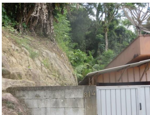
Figura 12. Residência muito próxima a maciço rochoso coberto por camada fina de solo. Setor SC_MASSARA_SR_2_CPRM.
