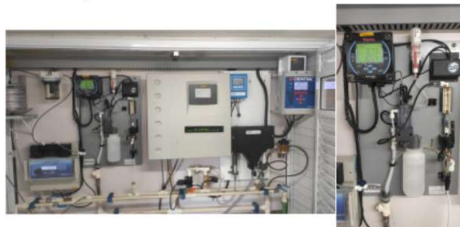
Figura 1: Set-up de automação de ETA. Lado esquerdo mostra o Set-up completo com medidor de Cor, Cloro, Flúor e Turbidez. O lado direito mostra o Medido por Íon-Seleto para Flúor. Fonte: CASAN.
