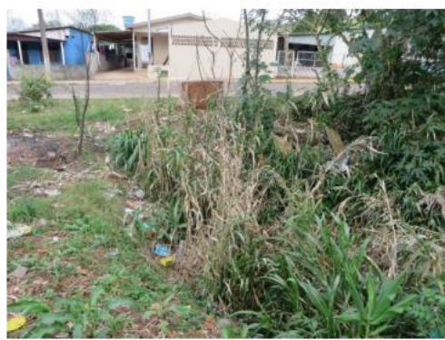
Figura 5: Córrego assoreado e canalizado.
